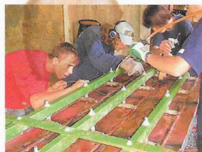
Dix-huit apprentis ferblantiers en pleine réalisation d'un système de chauffage solaire thermique.
